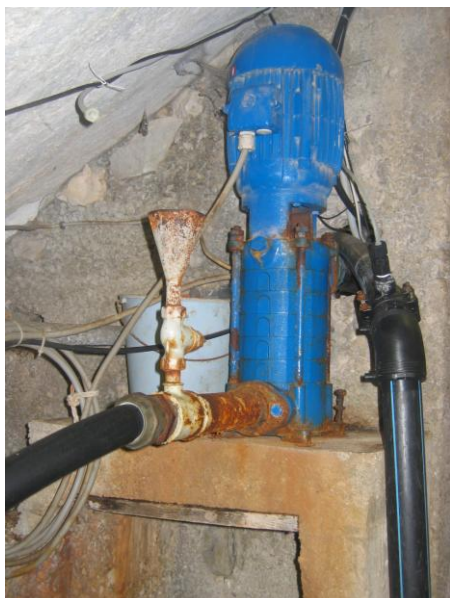
Slika 3. Pumpa vode - neorganizirani mjesni vodovod u naselju Sobra (otok Mljet).
